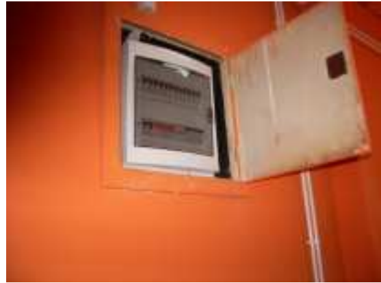
Il nuovo quadro elettrico
